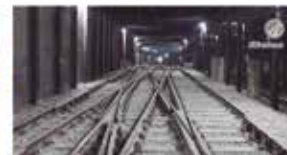
Doble diagonal instalada en Metro Buenos Aires
